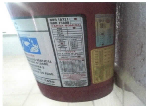
Manutenção extintores/ março
