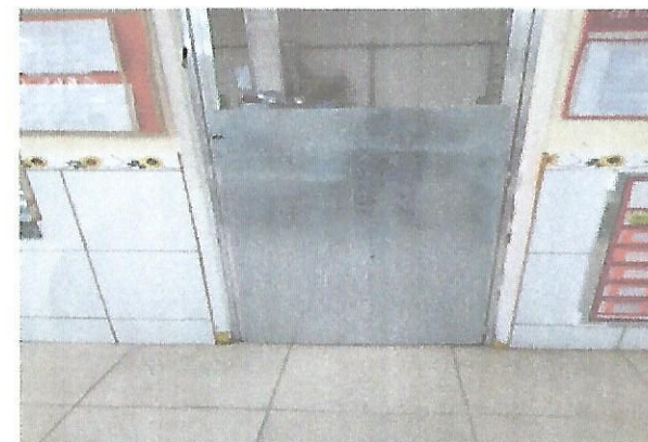
Placa de alumínio na porta cozinha
