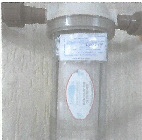
Troca de vela dos filtros
